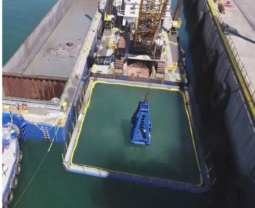
Mesures de précautions environnementales prises pendant le dragage (drague à godet étanche et rideau de turbidité de type Moon Pool).
